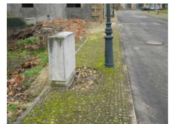
Pavimento em mau estado Trecho n.º 36
