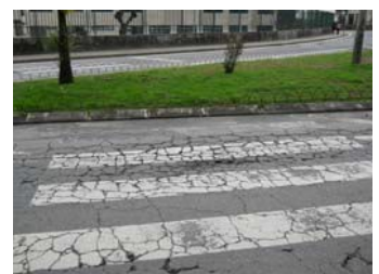
Inexistência de Rebaixamento Trecho n.º 91
