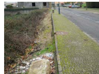
Inexistência de Guarda-Corpo Trecho n.º 37
