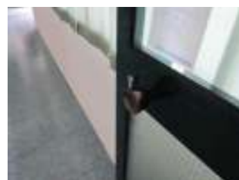
FIG. 21 - Porta com mecanismo de abertura não acessível
