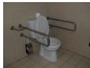
Sanita com barras de apoio inadequadas na Casa da Cultura
