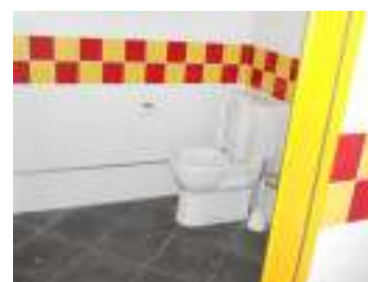
FIG. 31 - Sanita sem barras de apoio e mal localizada
