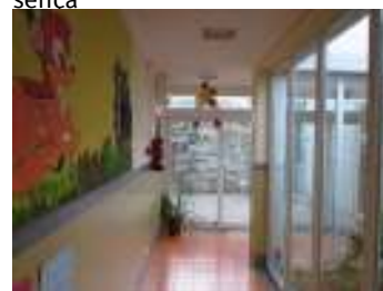
FIG. 36 - Superfícies envidraçadas não sinalizadas
