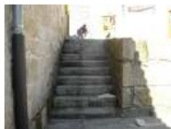
FIG.5 - Escada com degraus irregulares sem corrimão
