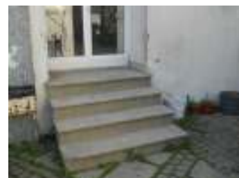
FIG. 9 - Degraus com focinho saliente e sem corrimão
