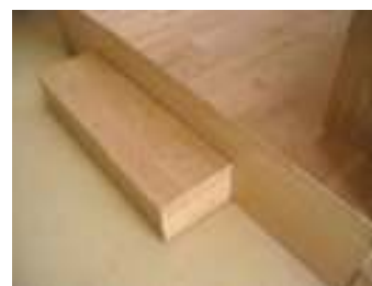
FIG.15 - Degraus isolados não sinalizados
