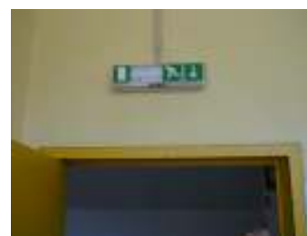
FIG. 45 - Sinalização de emergência
