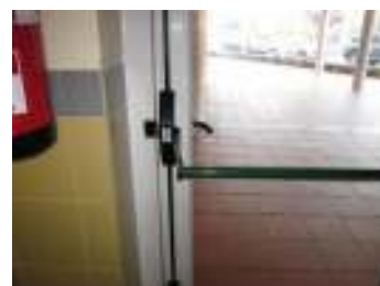
FIG. 20 - Porta com superfície envidraçada não sinalizada
