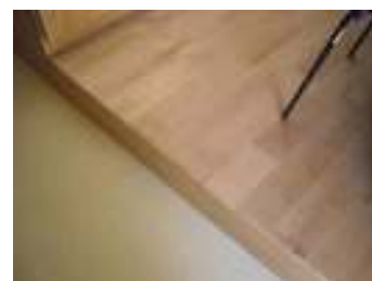
Degrau isolado no interior do auditório da Assembleia Geral
