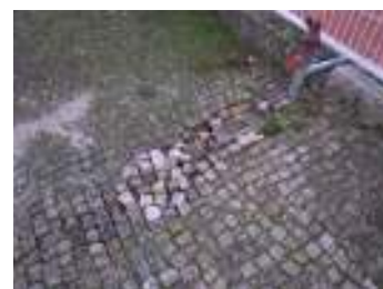
FIG. 5 - Obstáculos no percurso pedonal e pavimento danificado
