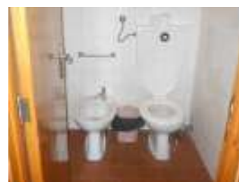
FIG. 29 - Porta de cabine com sentido de abertura desadequado
