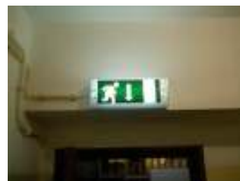
FIG. 23 - Sinalização a uma altura não acessível
