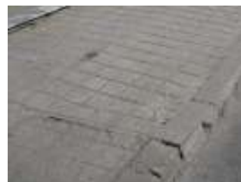
FIG. 8 - Revestimento do passeio e passadeira inacessível
