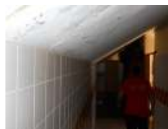
FIG. 50 - Corredor a uma altura inferior a 2m
