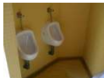
FIG. 28 - Vista do interior da cabine da IS masculina
