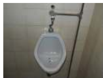
FIG. 19 - Louças cerâmica e acessórios inacessíveis
