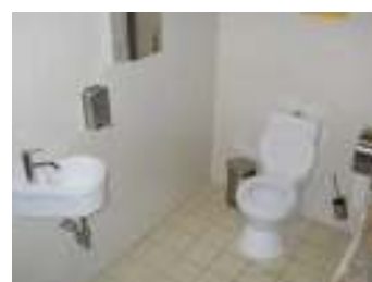
FIG. 61 - Vista interior de cabine
