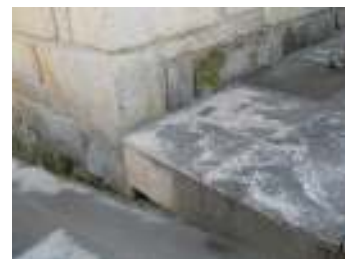
FIG. 12 - Degrau isolado no acesso aos gabinetes técnicos
