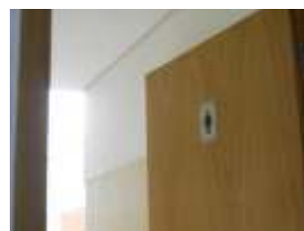
FIG. 18 - Sinalização das IS mal localizadas e inacessíveis
