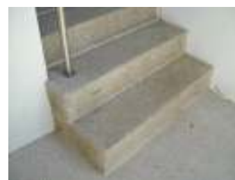
FIG.16 - Escadas não sinalizadas com corrimão não prolongado
