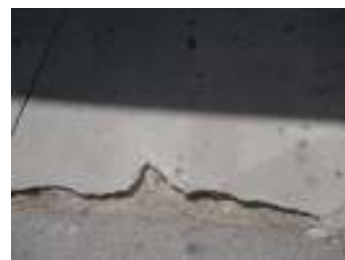
FIG. 14 - Perturbação de pavimento no acesso ao Bloco D
