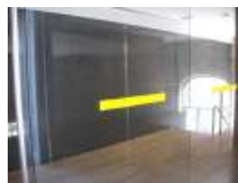
FIG.14 - Porta em vidro com sinalização inadequada.
