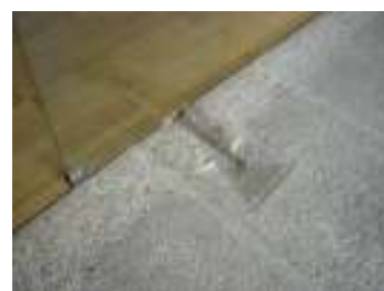
FIG.29 - Perturbação no pavimento
