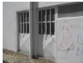
FIG. 28 - Porta de acesso ao piso -1
