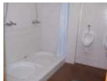
FIG. 28 - Degrau no acesso à base de chuveiro
