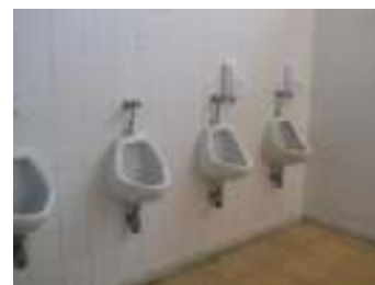
FIG. 32 - Mecanismos operáveis inacessíveis
