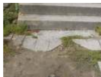
Pavimento em mau estado junto à Câmara Municipal
