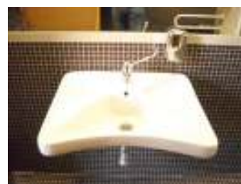
FIG.21 - Espelho instalado a uma altura não regulamentar
