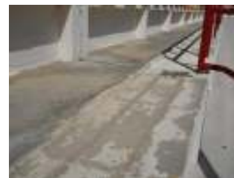
FIG. 17 - Ressalto no pavimento
