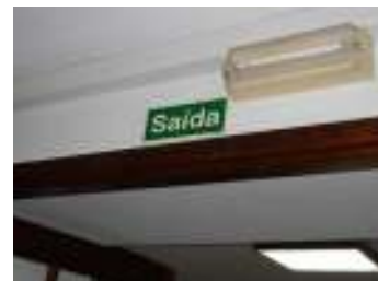
FIG. 38 - Sinalização de saída
