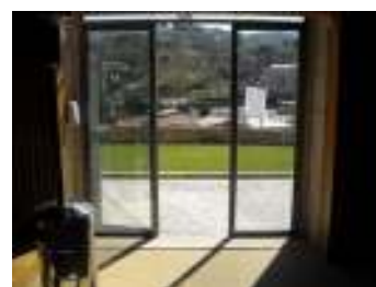
FIG.10 - Porta de acesso com ressalto e vão útil de passagem insuficiente
