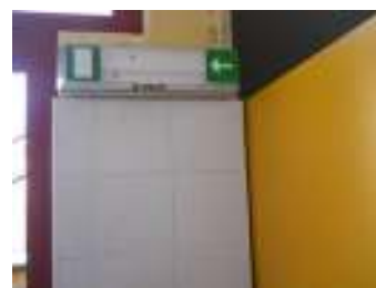
FIG. 44 - Sinalização de emergência
