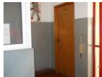
FIG. 18 - Porta de acesso a gabinetes
