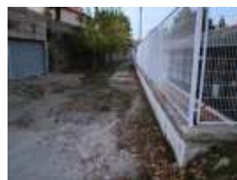
FIG. 9 - Passeio sem manutenção de limpeza
