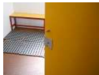
FIG. 13 - Mecanismo de abertura inacessível
