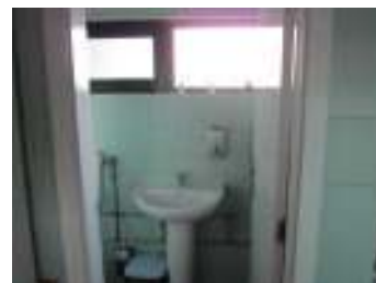
FIG. 31 - Porta com sentido de abertura inadequado
