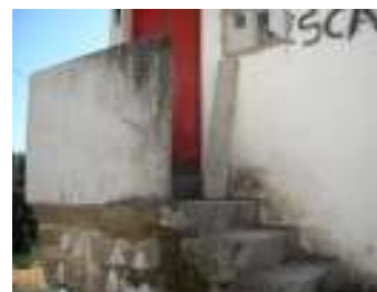
FIG.6 - Escada com dimensões não regulamentares
