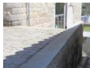
FIG. 19 - Plataforma sem guarda junto à Assembleia Geral
