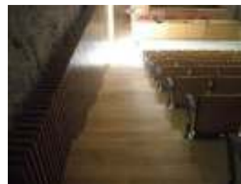
FIG.18 - Escadas do auditório sem corrimão
