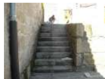
FIG.3 - Escadas com degraus com dimensões irregulares
