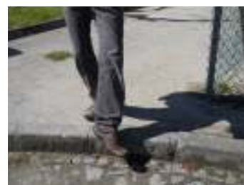
FIG. 11 - Degrau no acesso ao estacionamento junto ao piso -1
