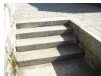
FIG.5 - Escadas sem sinalização e corrimãos
