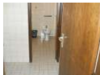
FIG. 15 - Portas das I.S. com largura insuficiente
