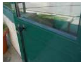
FIG. 21 - Mecanismo de abertura inacessível
