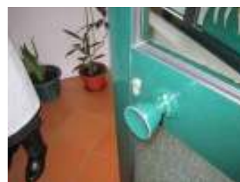
FIG. 19 - Porta com mecanismo de abertura não acessível
