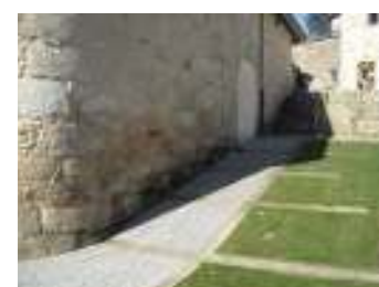
FIG.6 - Rampa com inclinação excessiva, sem sinalização e corrimãos
