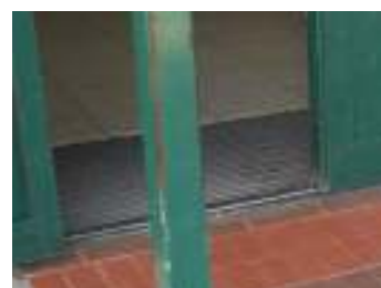
FIG. 48 - Grelhas junto às portas de acesso
