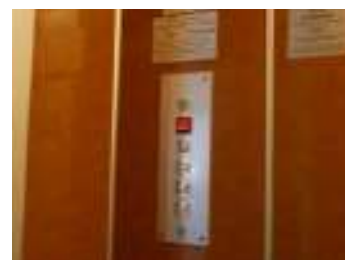
Comandos do elevador da Santa Casa da Misericórdia
