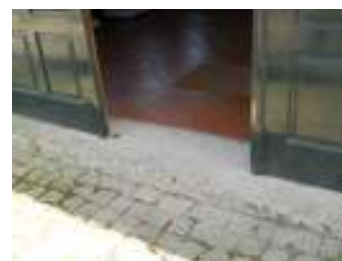
Ressalto no acesso ao Museu Municipal
