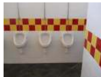
FIG. 36 - Urinóis com mecanismos inacessíveis
