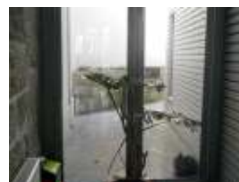
FIG. 25 - Detalhe interior da porta de emergência junto à recepção
