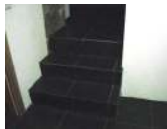
FIG.17 - Escadas não sinalizadas sem corrimãos
