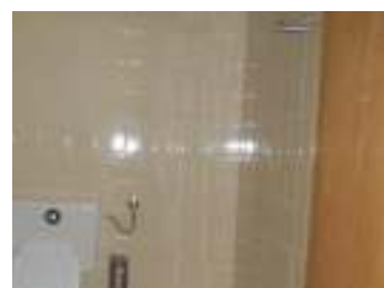
FIG. 16 - Cabides das cabines sanitárias inacessíveis
