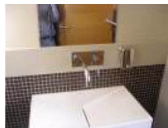
FIG.22 - Espelho instalado a uma altura não regulamentar
