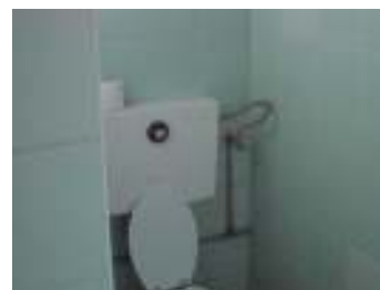
FIG. 30 - Mecanismos operáveis inacessíveis
