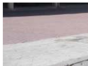
FIG. 5 - Pavimento em mau estado
