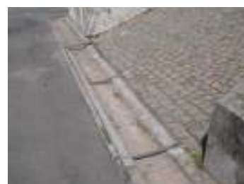
FIG. 9 - Vala sem grelha junto à rampa
