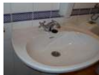
FIG. 36 - Lavatório com mecanismo operável inacessível
