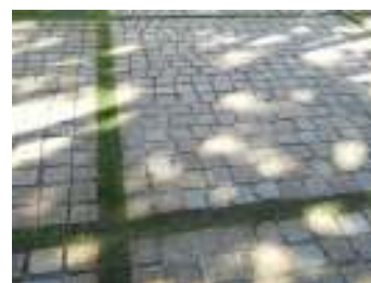
Pavimento irregular na envolvente da Câmara Municipal
