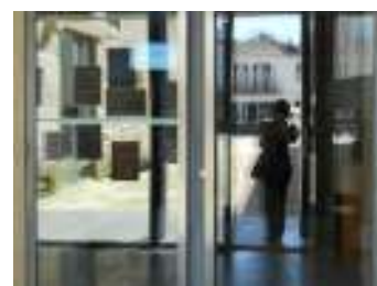
Mecanismo de abertura inacessível (Câmara Municipal)
