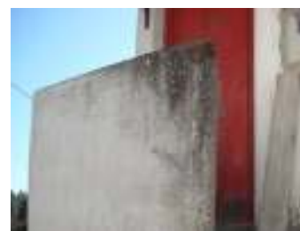
FIG.8 - Porta de acesso com degrau isolado
