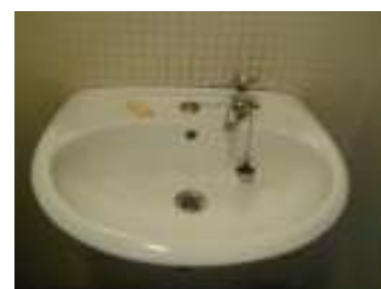
FIG. 15 - Mecanismo operável inacessível
