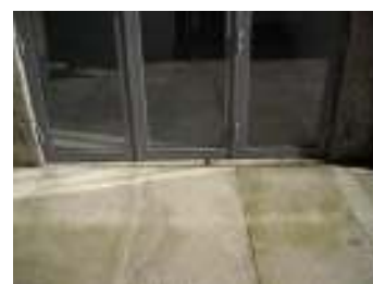
FIG.9 - Porta de acesso com vão útil de passagem insuficiente
