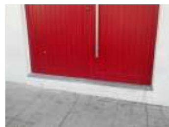
FIG. 11 - Ressalto na entrada para o edifício
