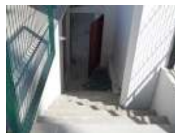
FIG. 10 - Escada sem corrimão nem faixas de sinalização
