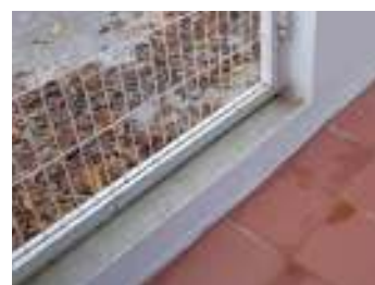
FIG. 15 - Degrau isolado no acesso
