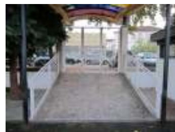
FIG. 12 - Rampa com inclinação excessiva
