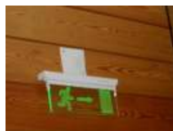
FIG. 75 - Sinalização de emergência
