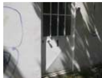
FIG. 27 - Porta de acesso ao piso -1
