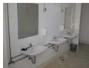
Lavatórios com mecanismos operáveis inacessíveis
