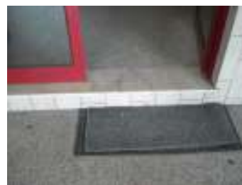
FIG. 9 - Ressalto no acesso ao interior
