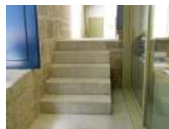
Corrimão inexistente na escada da Câmara Municipal
