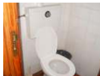
FIG. 27 - Mecanismo operável inacessível
