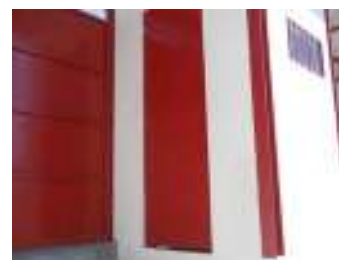
FIG. 16 - Porta com vão insuficiente
