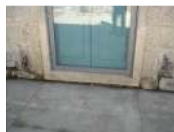
FIG.8 - Porta de acesso com degrau isolado
