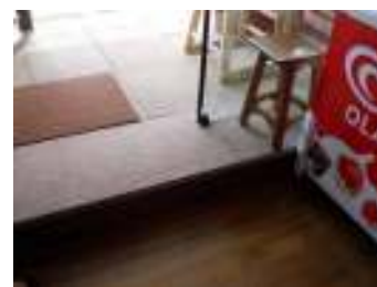
FIG. 7 - Degrau isolado no acesso á esplanada.
