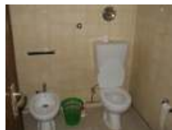
FIG. 20 - Louças cerâmica e acessórios inacessíveis
