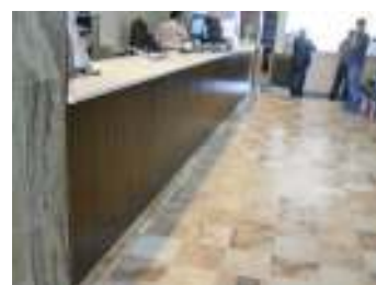
FIG. 24 - Balcão de atendimento ao público inacessível
