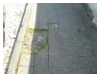
FIG. 5 - Pavimento do passeio inacessível
