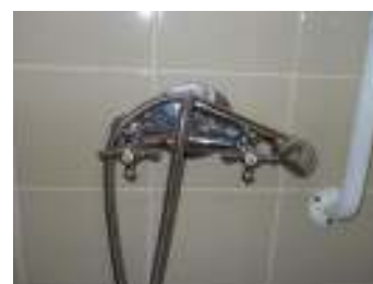
FIG. 35 - Mecanismo operável do chuveiro do banho assistido
