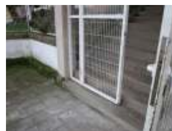
FIG. 11 - Escadas sem corrimão
