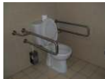
FIG. 22 - Sanita das instalações sanitárias para PMC
