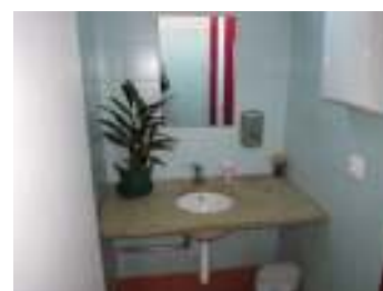
FIG. 27 - Espelho instalado a uma altura excessiva
