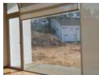
FIG. 11 - Varandas sem guarda-corpo
