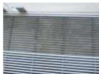
FIG. 19 - tapete inacessível no acesso ao edifício
