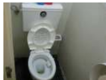
FIG. 16 - Mecanismo operável inacessível
