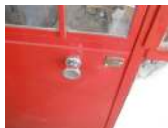
FIG. 15 - Mecanismo de abertura inacessível
