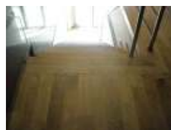
Escada com degraus sem sinalização na Assembleia Geral
