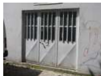
FIG. 29 - Porta de acesso ao piso -1
