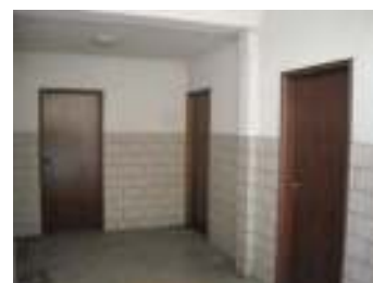
FIG. 13 - Wcs sem sinalização identificativa.
