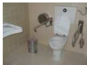
FIG. 13 - Sanita PMC mal localizada
