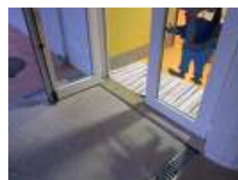
FIG. 16 - Porta de acesso com vão insuficiente
