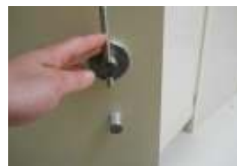
FIG. 14 - Mecanismos de abertura inacessíveis
