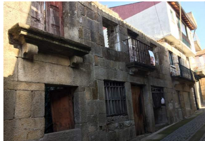
74 | Edifício em ruína
