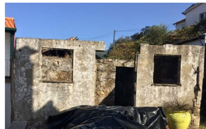
89 | Edifícios em Ruína
