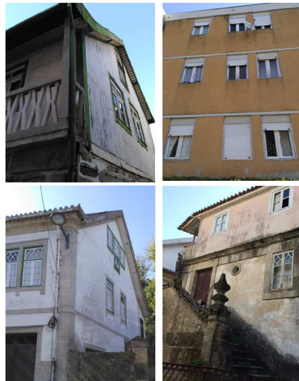
85 | Fachadas com manchas e humidade
