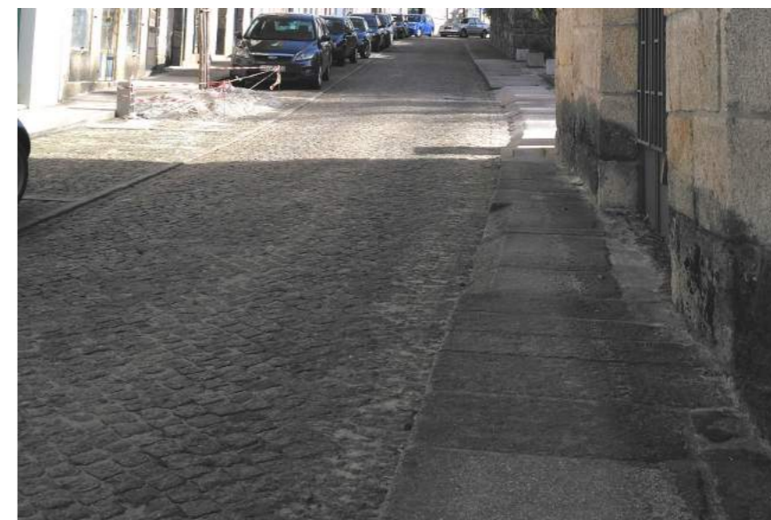
101 | Passeio sem dimensões adequadas à circulação pedonal em segurança
