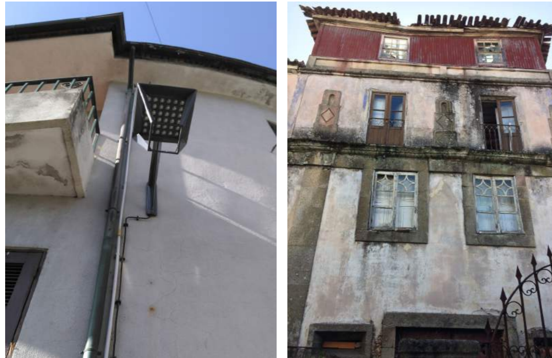
86 | Fachadas com manchas e bolores
