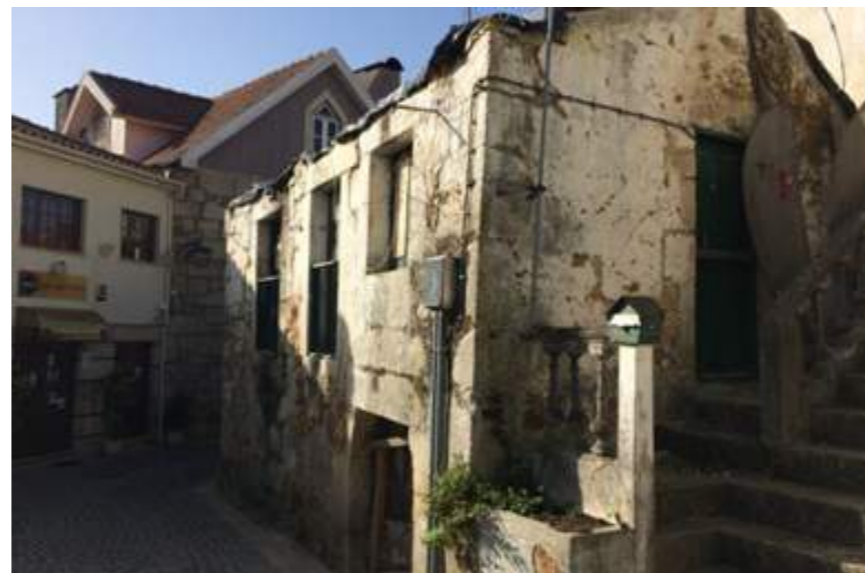
126 | Edifício em ruína para ampliação da Casa da Cultura
